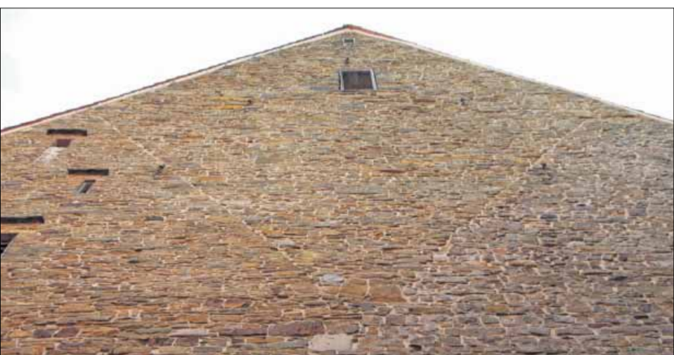
➤ Zwei Kirchen, jetzt unter einem Dach. Früher hatte jede ein eigenes. Bei genauem Hinsehen erkennt man die Veränderung im Mauerwerk.
